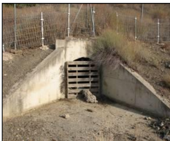
Foto derecha: Paso de fauna AVE obstruido
