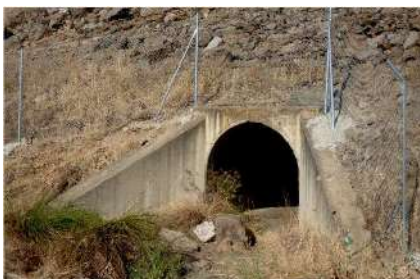
Figura 4: Obra de Drenaje Transversal adecuada tránsito de fauna.
